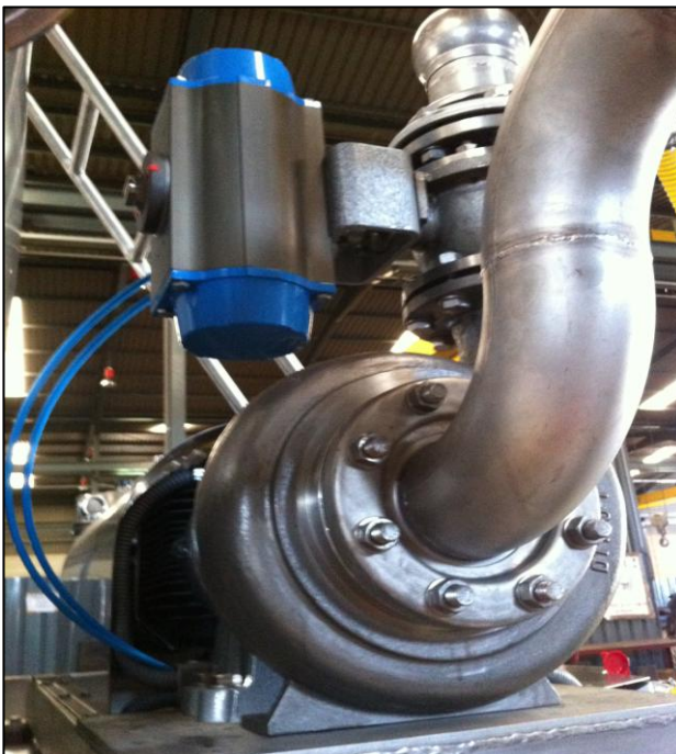
Colector salida bomba de trasvase
